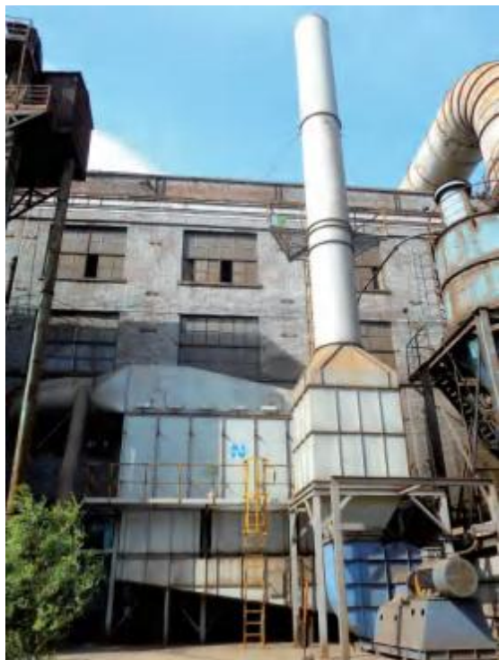
内蒙古第一机械集团有限公司改造后的除尘设备
