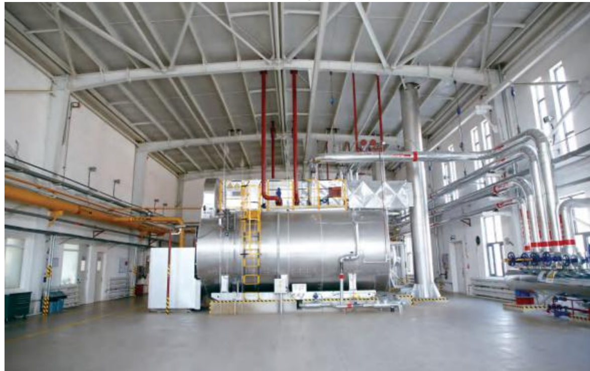
中核北方核燃料元件有限公司煤改气锅炉设备
