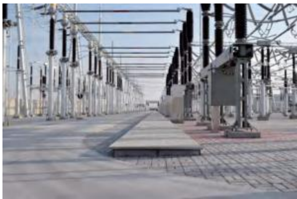
内蒙古电建三公司阿拉腾敖包开闭站工程
